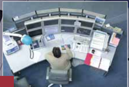
Deutschland Deutsche Bahn AG, München, Betriebszentrale
